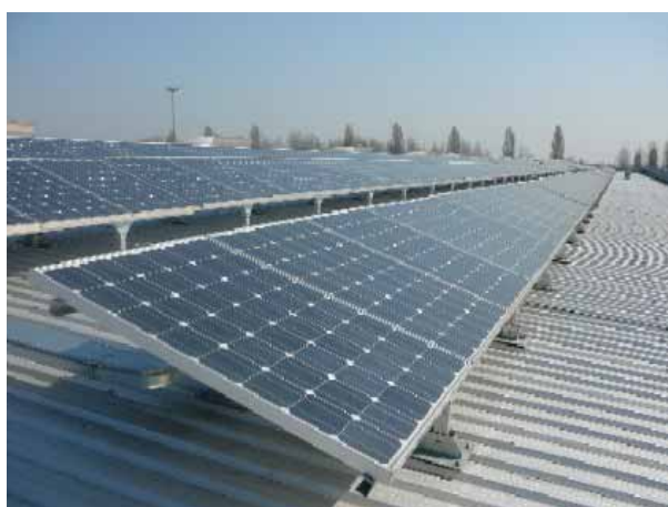
Vista dei moduli fotovoltaici SHARP
