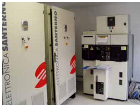
Inverter Elettronica Santerno e quadro di media tensione
